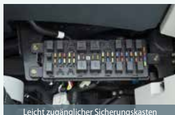
Leicht zugänglicher Sicherungskasten
